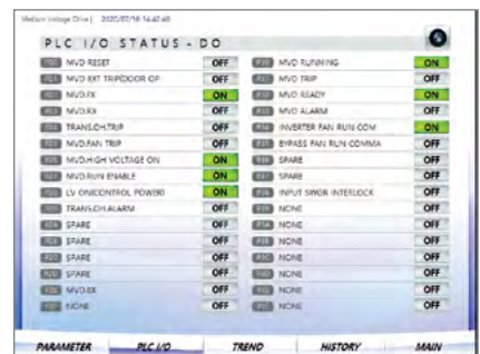
PLC 입출력 점접 확인
